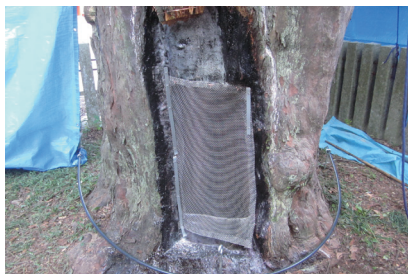
樹洞開口部防虫ネット蓋扉
